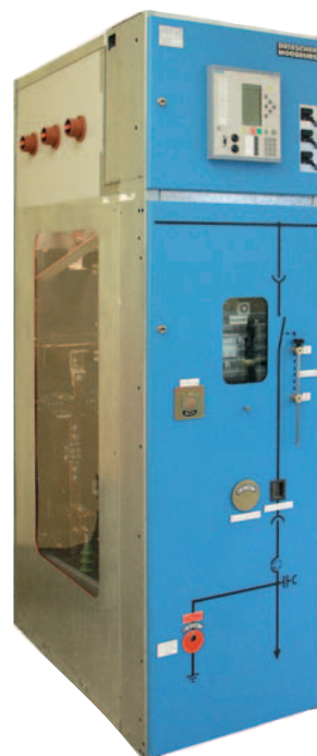
Bild 3: 12 kV Leistungsschalterfeld (WEL)
