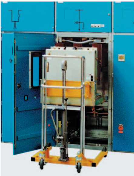
Bild 2: Herausnehmen des Vakuum- Leistungsschalter mittels Service- Hubwagen.
