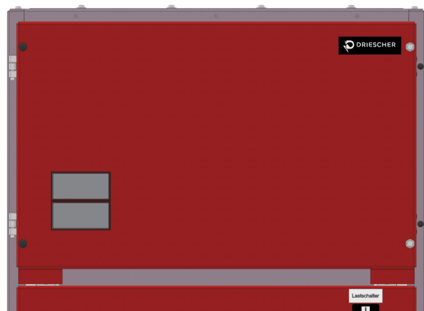
Bild 15: F-Feld mit kapazitivem Spannungsprüfsystem und Kurzschlussanzeiger
