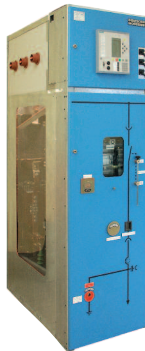
Bild 3: 12 kV Leistungsschalterfeld (WEL)
